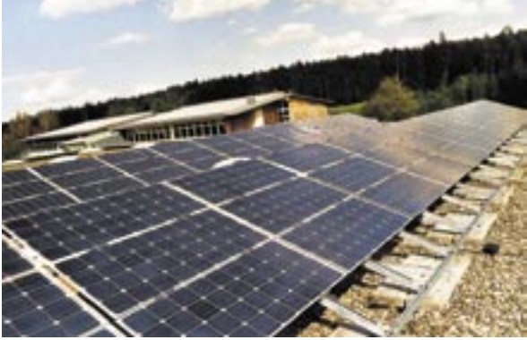
Photovoltaikanlage in Königsfeld
