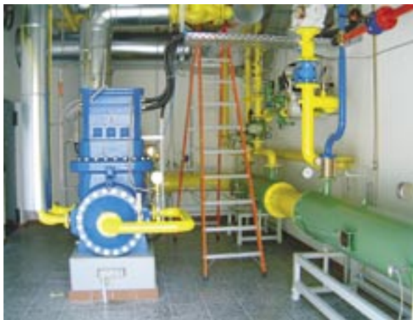
Erdgasentspannungsanlage in Osnabrück
